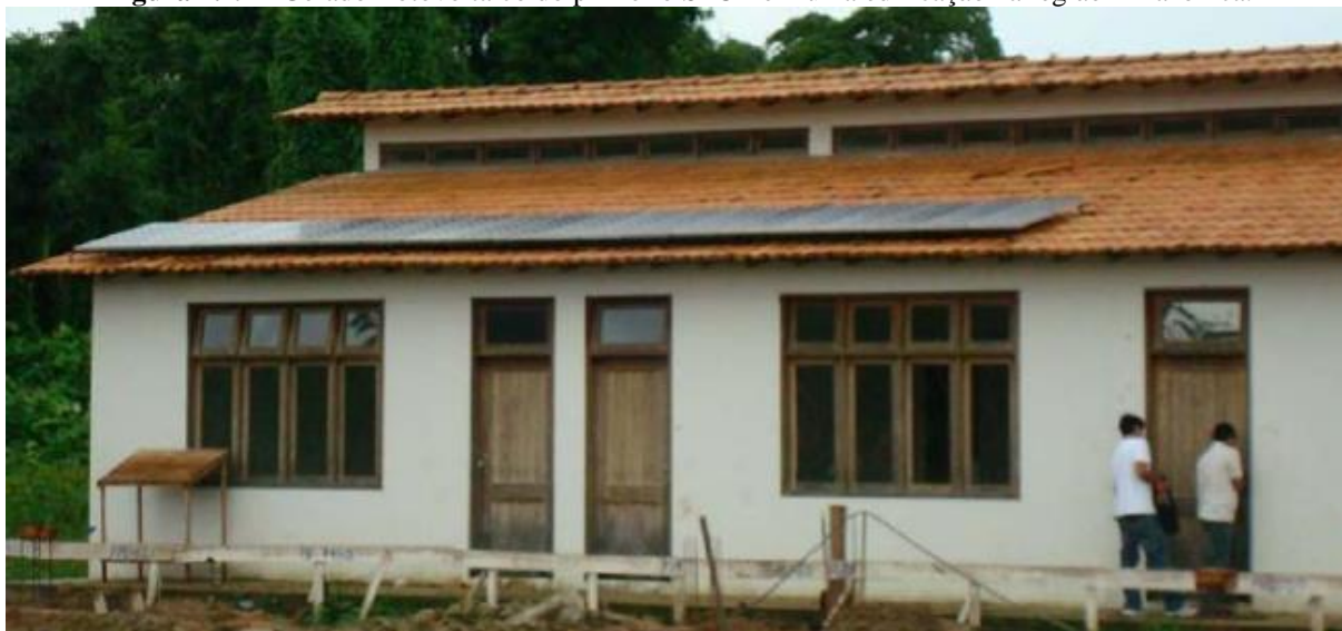
Figura 1.19 – Gerador fotovoltaico do primeiro SFCR em uma edificação na região Amazônica.
