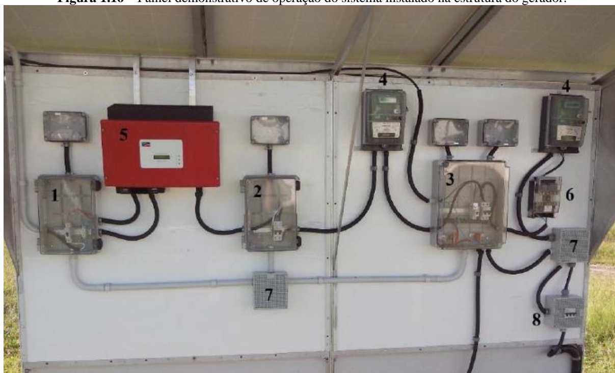
Figura 1.16 – Painel demonstrativo de operação do sistema instalado na estrutura do gerador.
