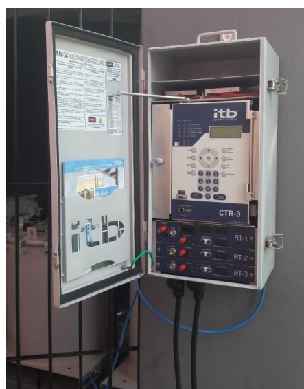
Figura 26 – Controlador CTR-3 dos reguladores de tensão monofásicos. Fonte: Próprio autor.
