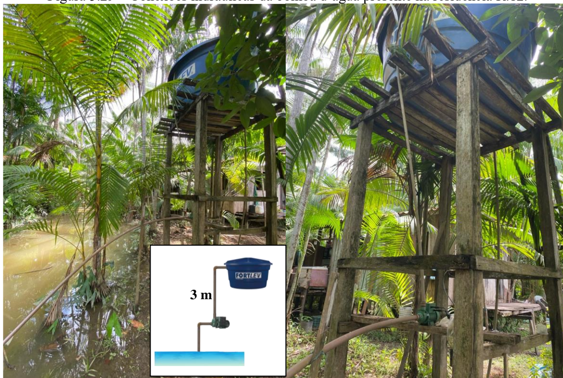
Figura 5.29 – Conexões hidráulicas da bomba d'água presente na residência R.12.
