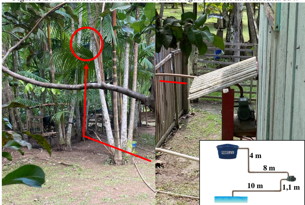
Figura 5.27 – Conexões hidráulicas da bomba d'água presente na residência R.4.
