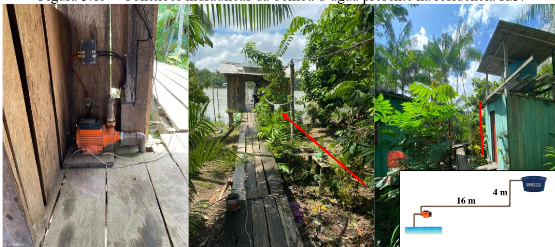
Figura 5.19 – Conexões hidráulicas da bomba d'água presente na residência R.5.
