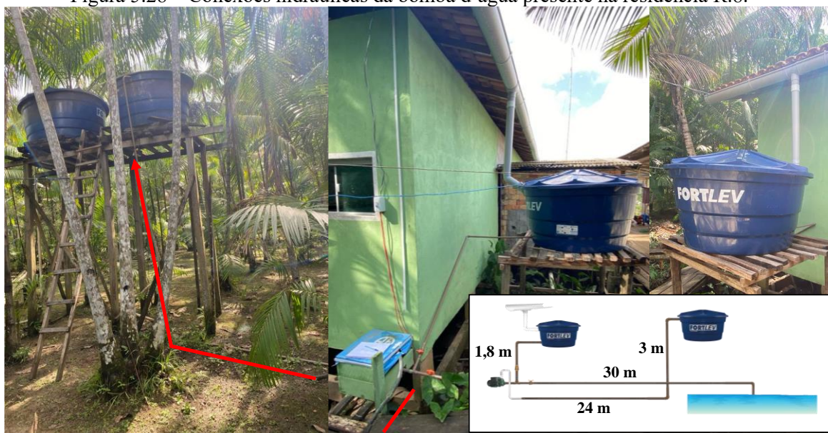
Figura 5.28 – Conexões hidráulicas da bomba d'água presente na residência R.8.
