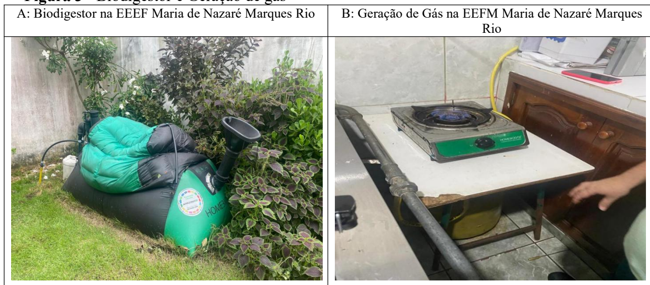
Figura 3 - Biodigestor e Geração de gás
