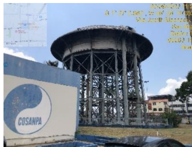
RAP em funcionamento e REL sem funcionamento
