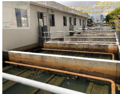
Filtros em funcionamento (ETA São Brás)
