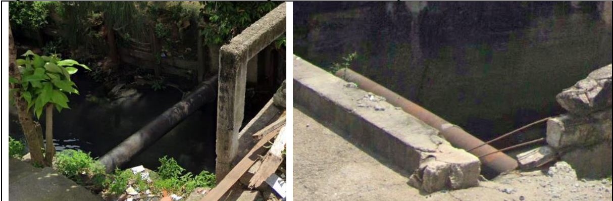
Figura 15 – Redes de abastecimento de água tratada em situação de vulnerabilidade
