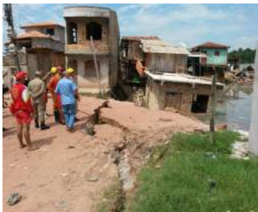
Figura 20 – Rachaduras no solo na área do desastre
