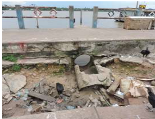
Figura 23 – Drenagem danificada da orla
