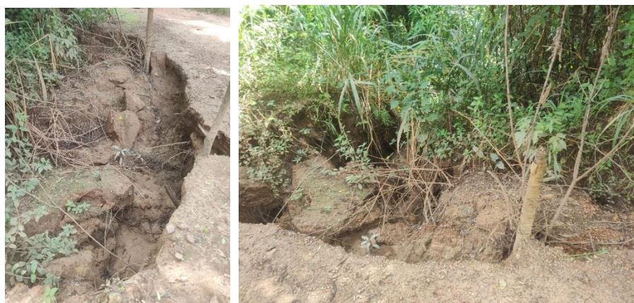
Imagem 07 – Erosão provocada pela passagem de embarcações
