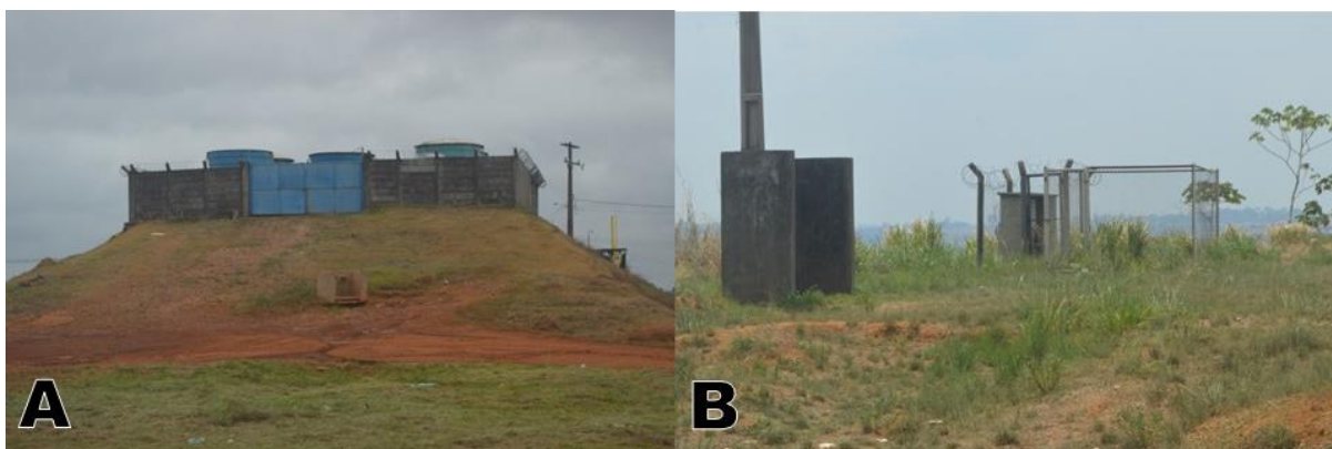
Figura 22. Sistema de Abastecimento de Água A: Conjunto de Caixas D'águas do RUC; B: Poço Artesiano do RUC. Fonte: Acervo Pessoal, 2023.
