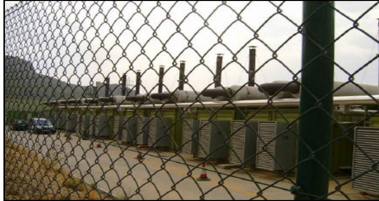
Figura 13 - Vista dos geradores de energia elétrica a partir do Bombeamento do gás gerado no aterro sanitário de Garraf em Barcelona (ES).
