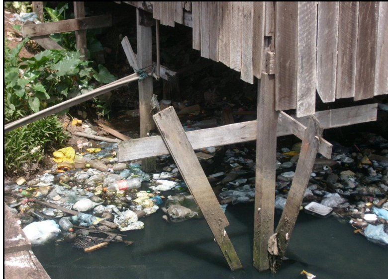
Figura 30 - Lixo acumulado dentro do canal da Quintino com Bernardo Sayão, Belém (PA).
