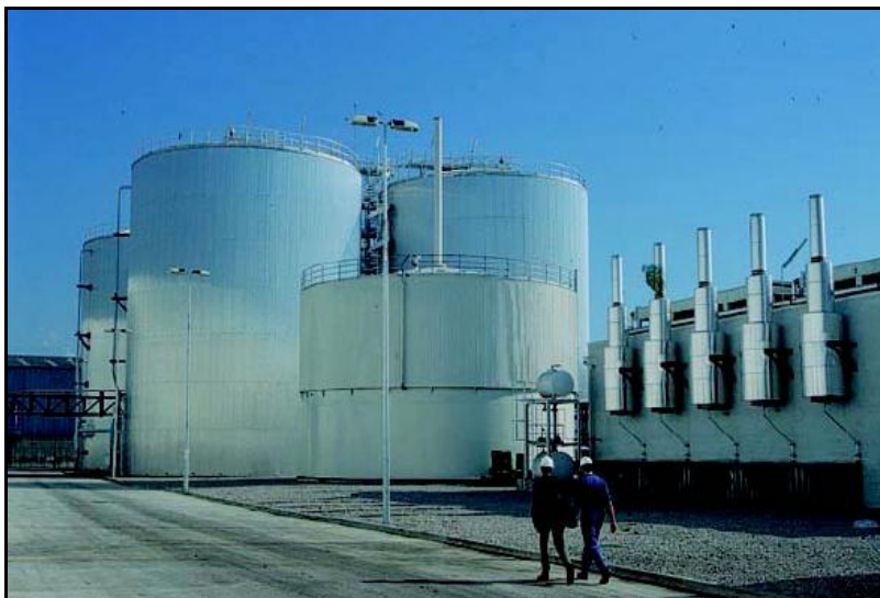
Figura 7 - Instalações do biodigestor no ecoparque 1 em Barcelona (ES) Fonte: EMB, 2005.
