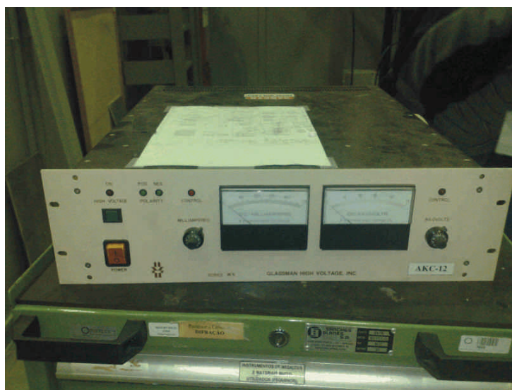
Figura 30: Fonte de alta tensão utilizada na estação XRD1.
