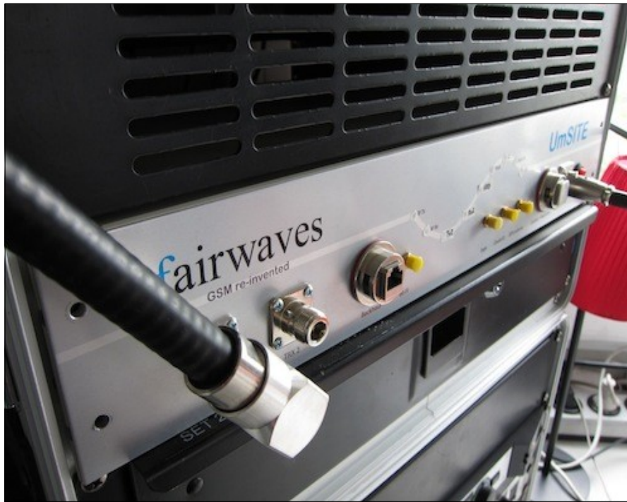
Figura 2.11 - Site exemplo de instalação do UmSITE ® (Fonte: UmSITE ® 2014).
