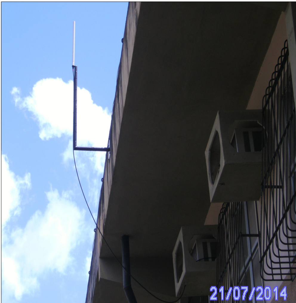
Figura 4.7 - Antena instalada no topo da lateral do Laboratório de Engenharia Elétrica e da Computação (Fonte: próprio autor).
