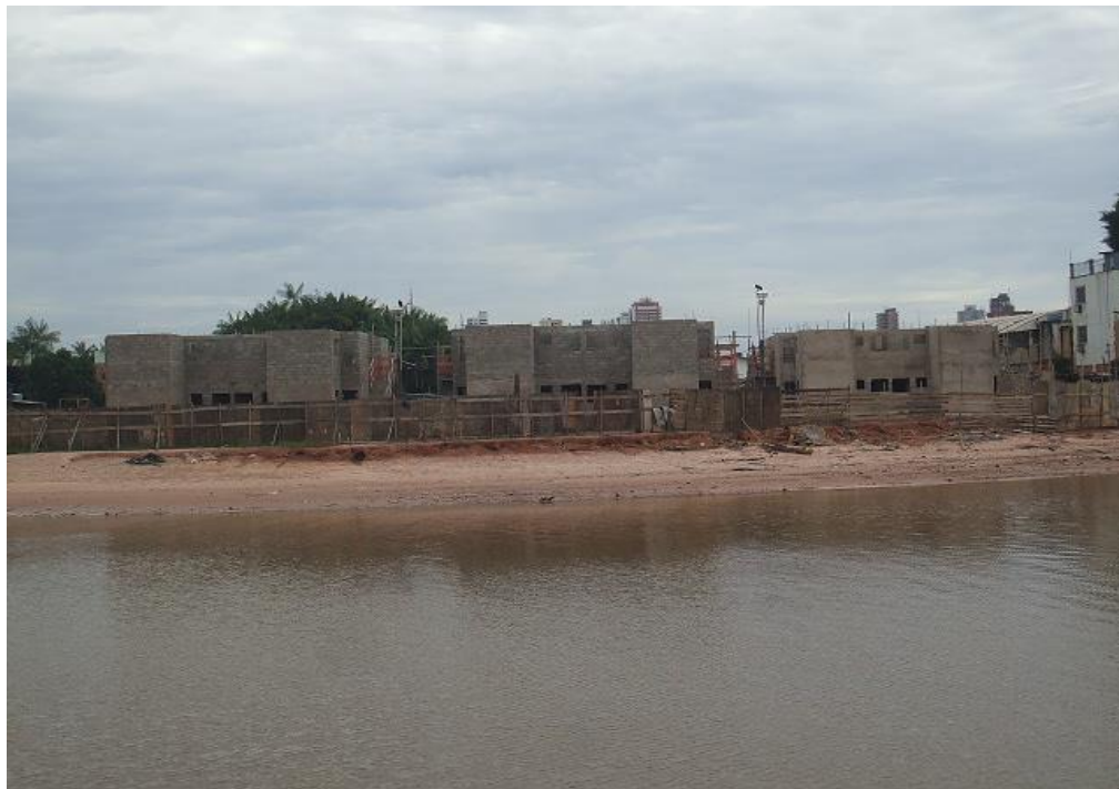
Fotografia 9 - Unidade habitacional interdita.
