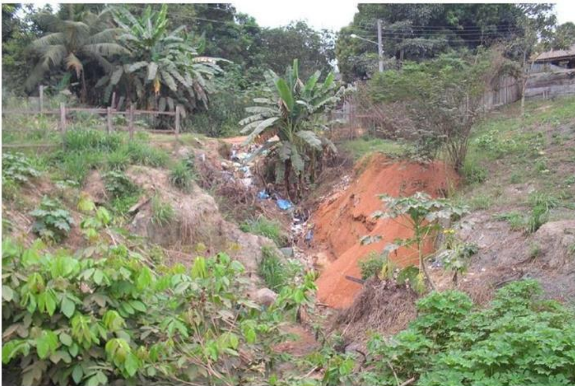
Figura 11: Erosão Jaderlândia em 2013.
