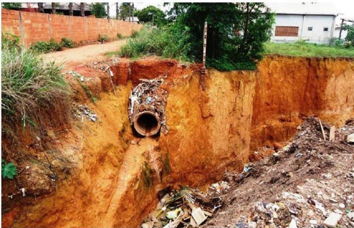
Figura 06: Erosão Gusmão em 2013.
