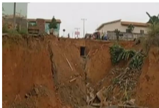
Figura 19: Ponto de deságua de águas pluviais em galerias em Rondon do Pará (na Rua Bahia) em 2015, a esquerda, e em 2016, a direita.
