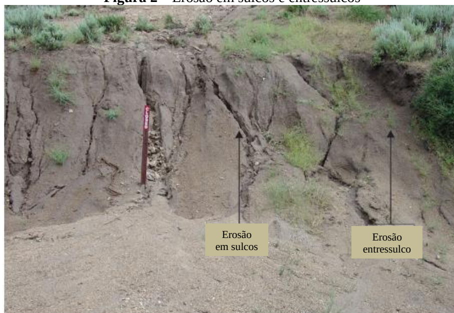
Figura 2 – Erosão em sulcos e entressulcos
