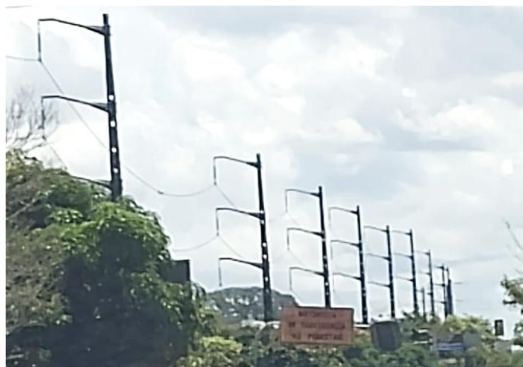
Figura 1.4 – Exemplo de linhas de transmissão de energia elétrica.
